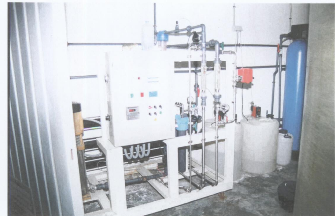
Clorador en el depósito.
